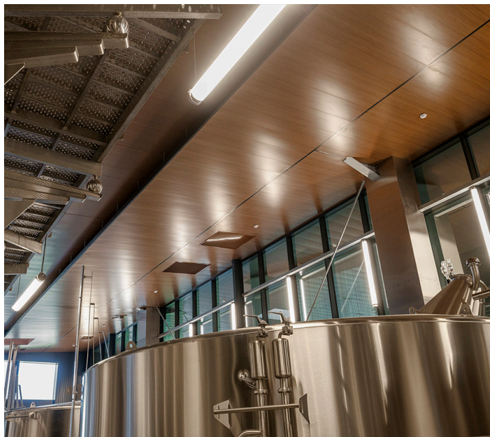
© Cuverie - imaginé par le cabinet Soret Defrance Architectes, conçu et réalisé par le Bureau d'Études SAT Manager
